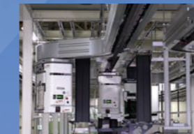
OHT (Overhead Hoist Transport) for Semiconductor Fab.
